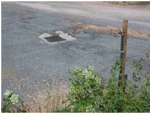
Rejilla sobre asfalto en Cordes sur Ciel (12)
